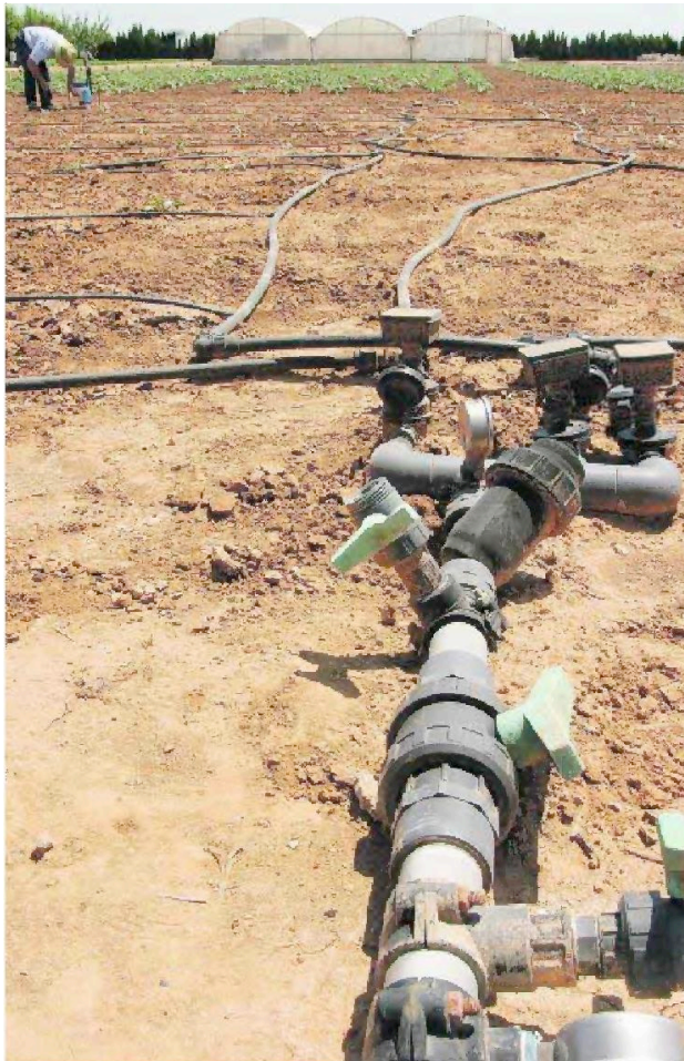
Válvulas y automatismos en la red de riego a goteo de Fundación Ruralcaja. :: LP
